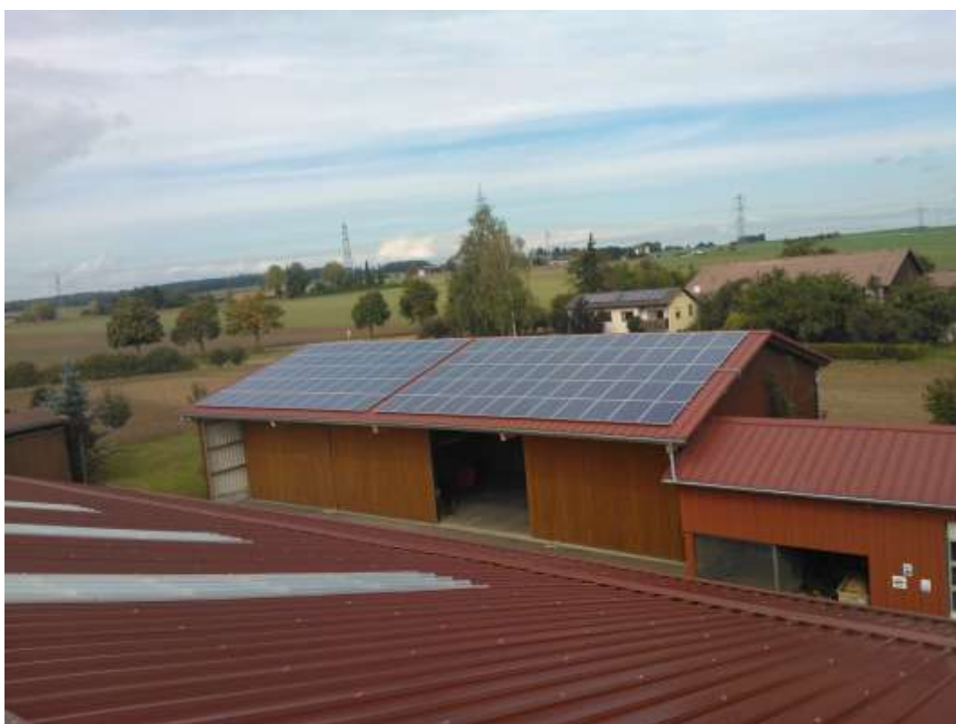
Instalacja solarna na dachu wiaty na sprzęt rolniczy ( źródło – RAWICOM )
