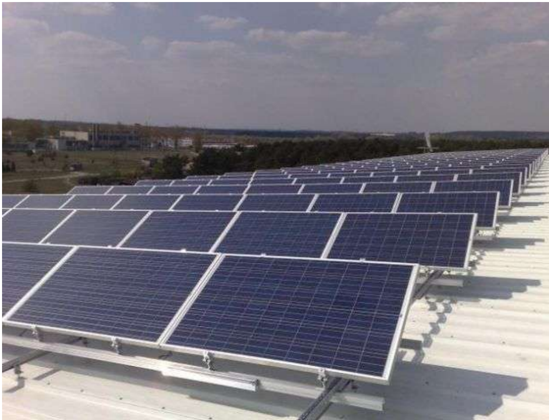
Elektrownia słoneczna na dachu chłodni firmy FROSTA w Bydgoszczy
