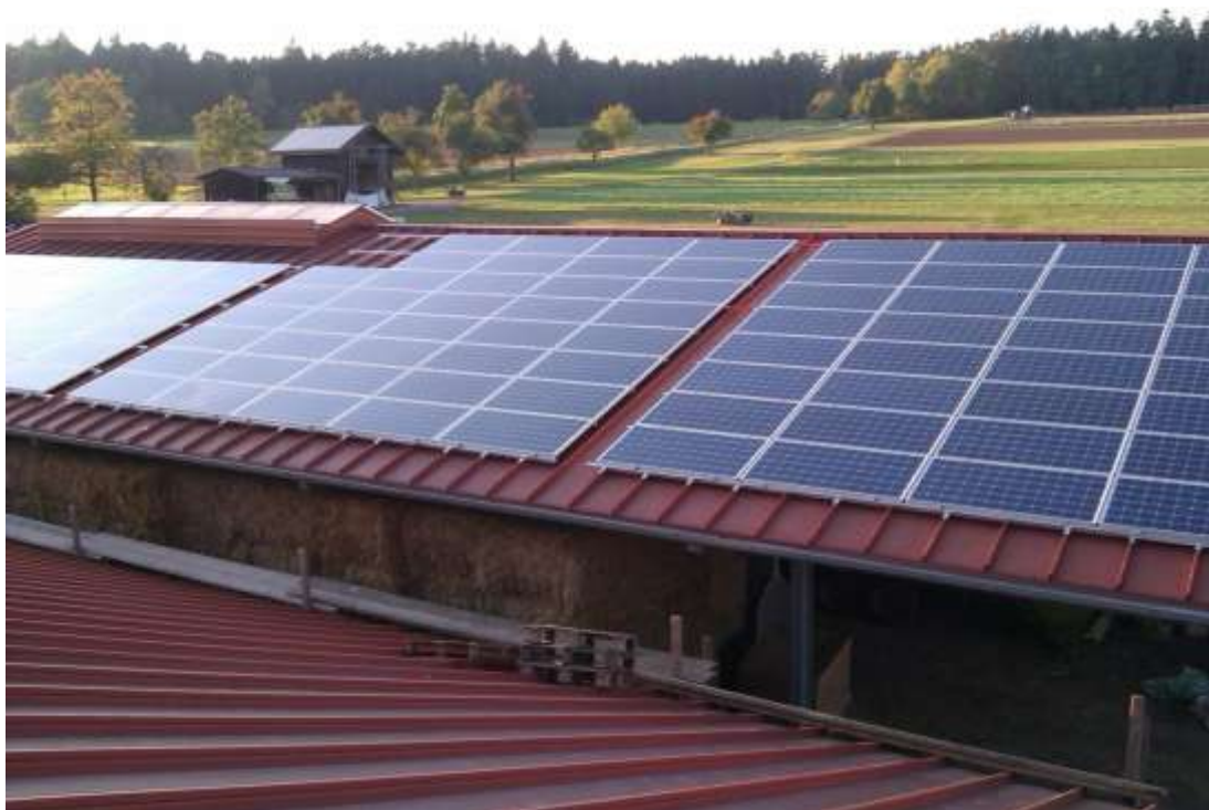
Instalacja solarna na dachu wiaty na słomę (źródło – RAWICOM)
